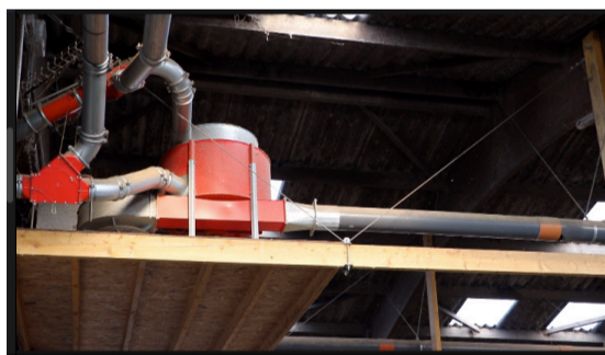
A l'intérieur du bâtiment : l'unité de transfert sur laquelle un aspirateur est branché pour aspirer la poussière. On peut installer jusqu'à 7 circuits indépendants à partir d'une seule machine. DR
